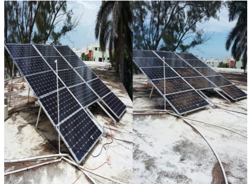
Vista paneles limpios contra paneles sucios
